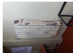
Telpu apkures risinājums - esošā čuguna radiatoru tīrums un aprīkojums ar temperatūras regulāciju
